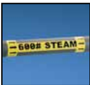
Kennzeichnung von Rohren
