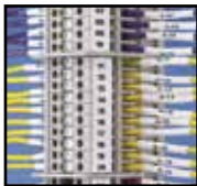
Beschriftung von Verteilern
