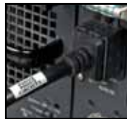
Beschriftung von Elektroninstallationen
